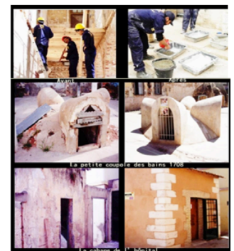
Fig3 : Restauration effectuée par les stagiaires de l'école chantier, Source : l'association Santé Sidi el Houari
